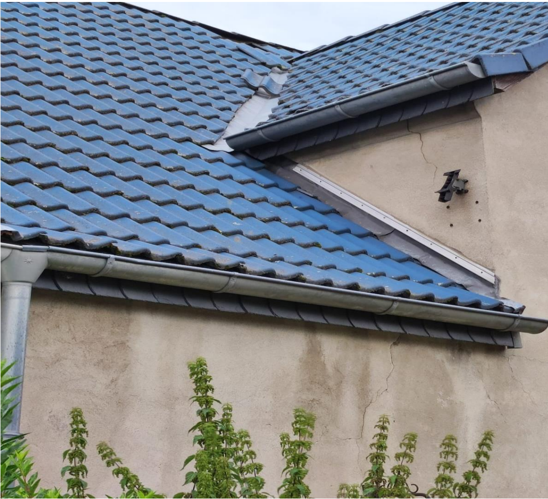
Bild 1: Schaden am Dach
