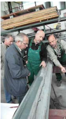
Begutachtung des freigelegten und behandelten Risses an der Guss säule des Lutherdenkmals
